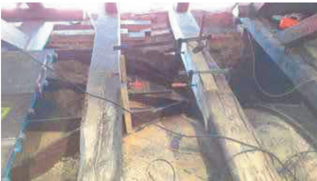
schadhafte Deckenbalken in der Stadtkirche
